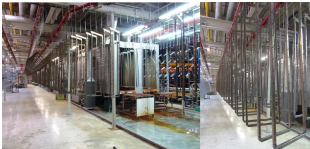
La planta de pre-tratamiento en la empresa Kesseböhmer
